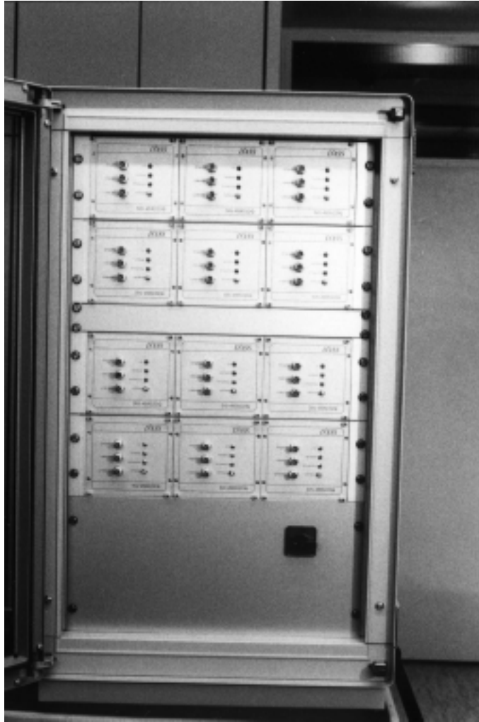
Bild 31: Vorderansicht des Schaltschranks
