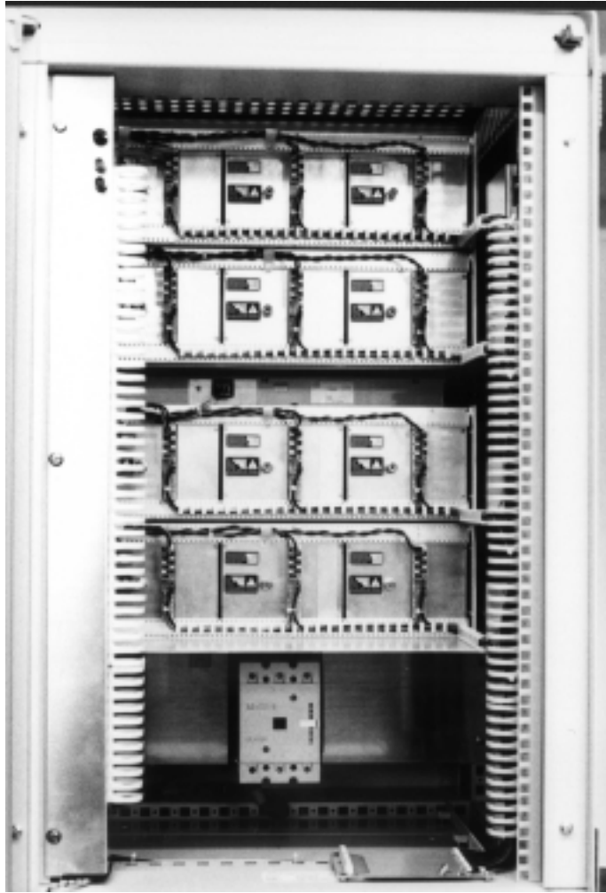
Bild 32: Rückansicht des Schaltschranks
